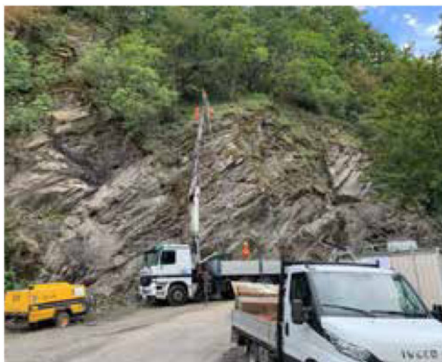
Versante roccioso instabile pre intervento - Fopla di Solignano (PR)
