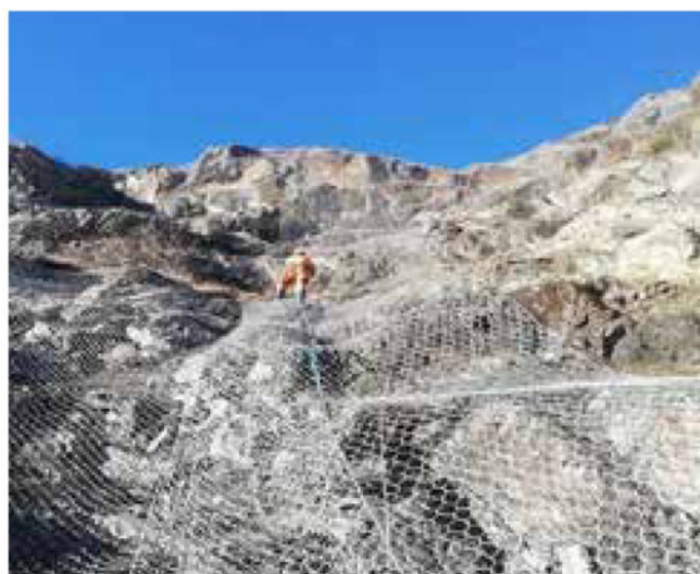
Rete Paramassi potenziata ArrFort - Val d'Ossola (VB)
